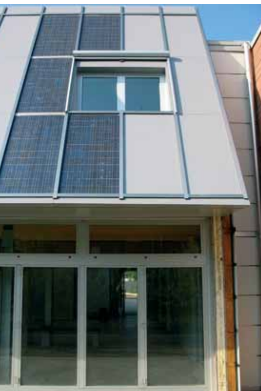
Figura 7 - Vista frontale della facciata sud. In evidenza i pannelli fotovoltaici per la produzione di energia elettrica e acqua calda sanitaria
